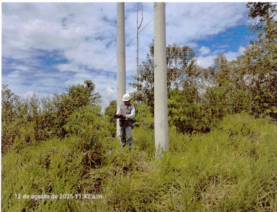
Fotografía N° 7: Vista de transformador de energía eléctrica.
