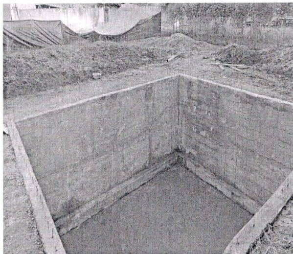
Fotografía N° 1 Caja porta tanques
