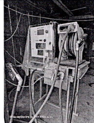
Imagen 5: Dispensador utilizado para el expedio de combustibles líquidos
