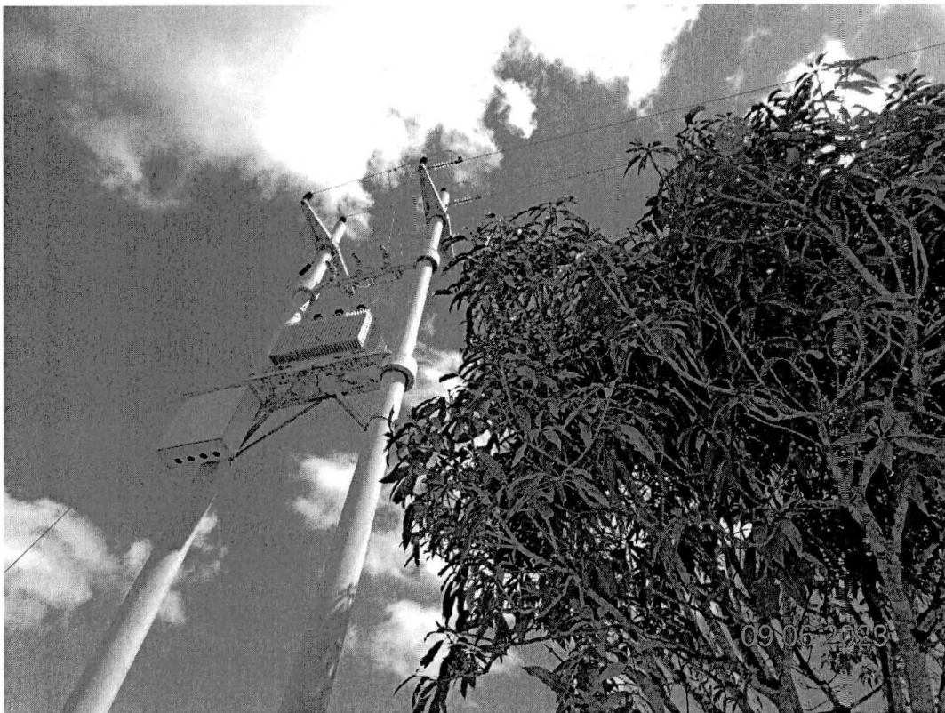
Fotografía N° 8: Vista de la sub estación eléctrica.
